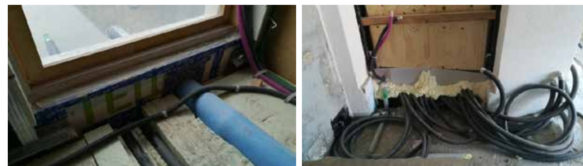
Figura 8.23 – Esempio di passaggio impiantistico ben realizzato (sx) e mal realizzato (dx) nella stessa abitazione.
