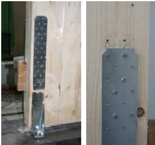
Figura 5.2 - Hold-down sovrachiodato; essendo la resistenza della chiodatura superiore alla resistenza della piastra metallica, la rottura avviene in maniera fragile su quest'ultima.
