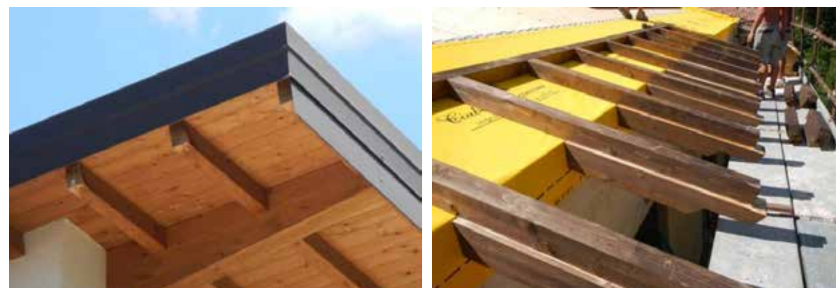
Figura 7.22 - Estremità dei travicelli non sufficientemente arretrati o protetti. Figura 7.23 - Dettaglio dei passafuori in legno su una copertura Xlam.
