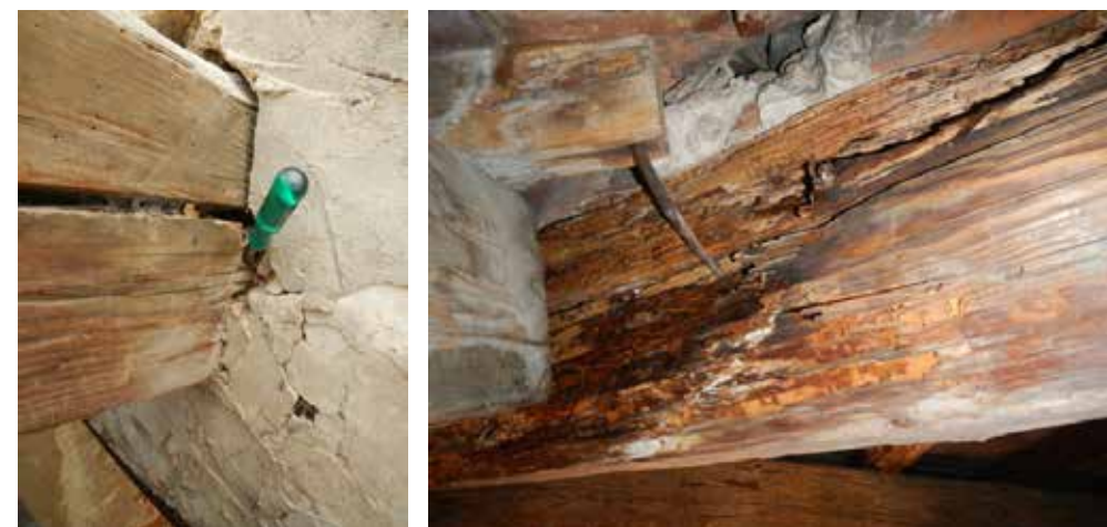
Figura 2.17 - tipico attacco da carie che si osserva nelle strutture dei sottotetti: l'attacco si sviluppa in corrispondenza della testata della trave, dove questa è inserita nella muratura e dove generalmente si riscontrano infiltrazioni di acqua dall'esterno.
