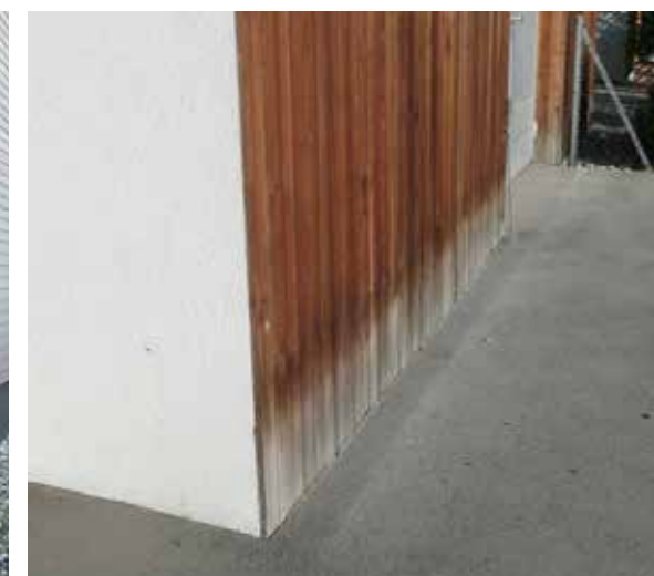
Figura 5.12 - Edificio realizzato in legno con elementi esposti (non protetti) al degrado nella zona di attacco a terra (esempio)
