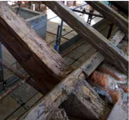
Figura 4.9 – Elemento cariato in prossimità dell’appoggio murario – Esempio.
