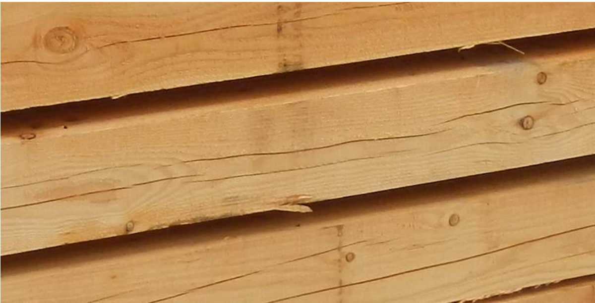
Figura 2.5 - Presenza di fessure da ritiro su elemento in legno massiccio curvo – le fessure da ritiro nella generalità dei casi non devono prestare preoccupazioni in quanto fenomeno legato al comportamento del legno nei confronti dei processi di stagionatura o essiccazione.
