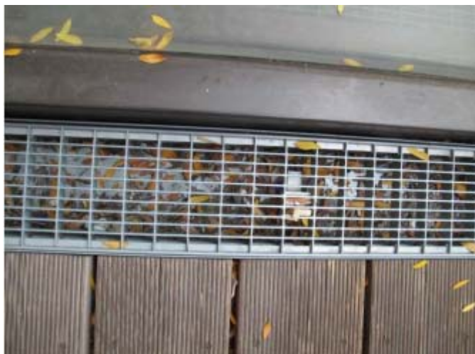
Figura 7.8 – Canaletta di scolo riempita con fogliame e sporcizia. Questa deve essere pulita e sottoposta a lavori di manutenzione regolarmente per garantire un funzionamento continuo
