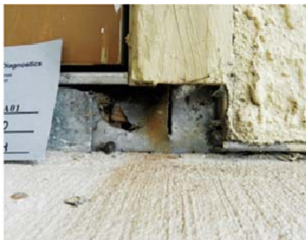
Figura 7.17 – Scossalina già danneggiata
