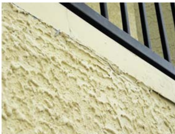
Figura 7.18 – Zone di marcescenza del legno possono essere localizzate in prossimità dei gocciolatoi; nella figura sopra riportata infatti non è visibile l'estremità del gocciolatoio stesso. Questo favorisce l'ingresso di acqua dietro l'intonaco
