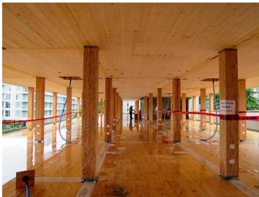
Figura 6.6 - Brock Commons – Fase di cantiere a seguito di nubifragio
