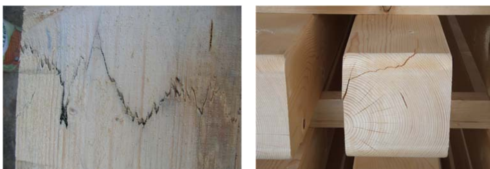
Figura 2.9 – Lesioni sulla faccia (sx) o in testa all'elemento (dx).
