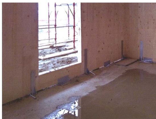
Figura 7.4 – Attacco a terra non corretto; la parete in CLT è stata posata direttamente sulla platea senza una guaina di separazione.
