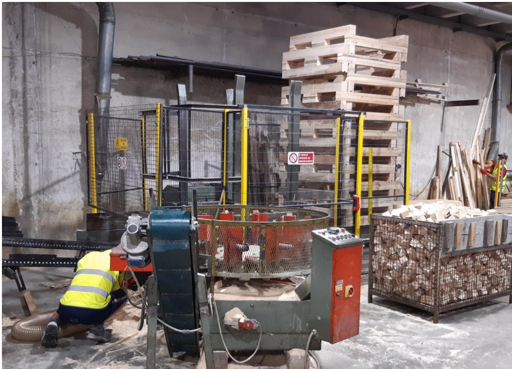
Figura 114 – Vista dell'accatastatore per pallet di cui alle foto precedenti su cui sono stati installati dei ripari fissi e mobili interbloccati al fine di prevenire il rischio di contatto con elementi mobili.
