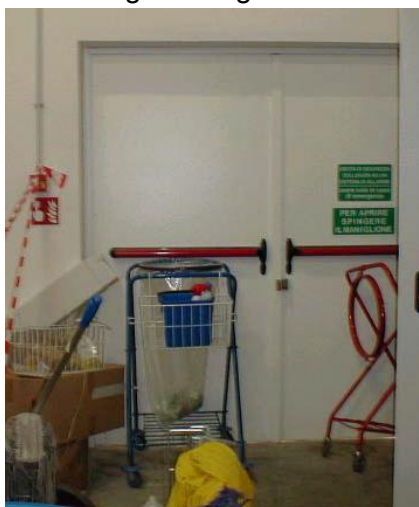
Figura 136 – Esempio di uscite di emergenze ingombre di materiali.
