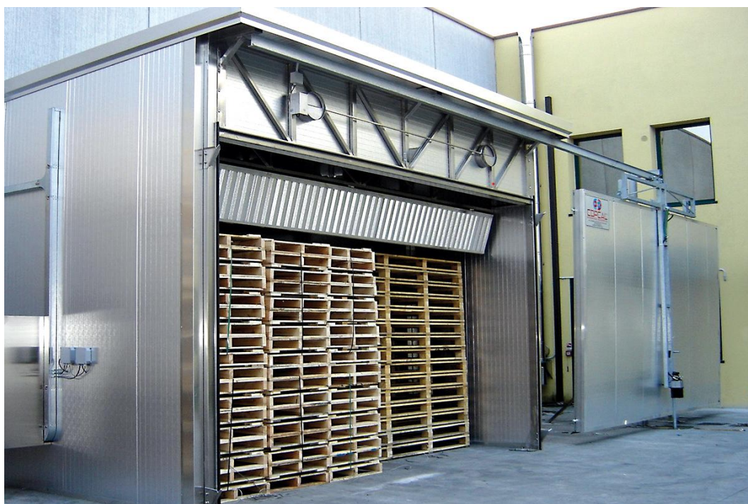
Figura 31 - Forno per trattamento HT su pallet in legname.
